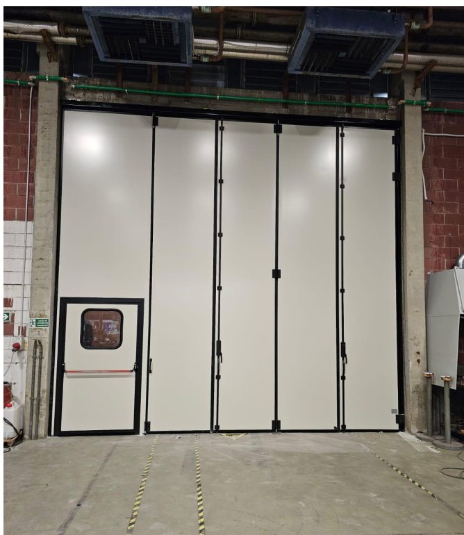
Portone a libro con ingresso pedonale dopo nostro upgrade
