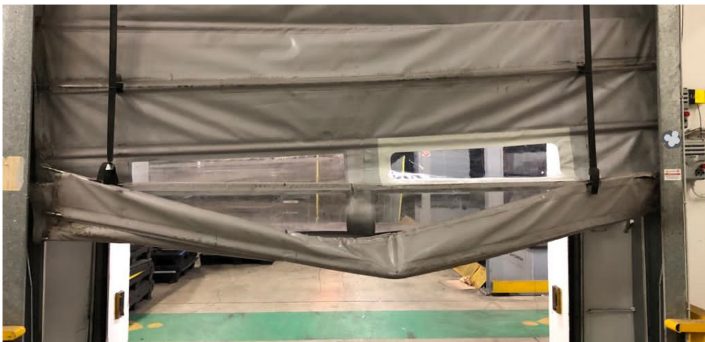
Distacco totale della cinghia di sollevamento centrale. Pericolo di distacco del telo con barre in ferro.
